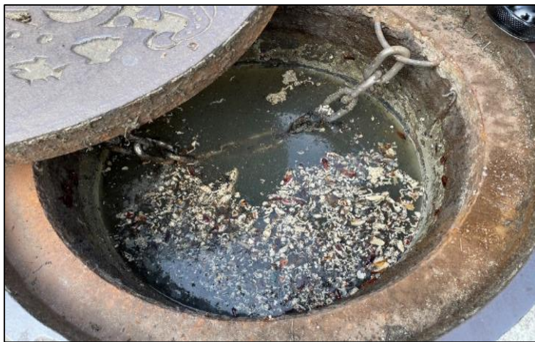
未裝設油脂截流器， 污水管受油脂殘渣阻塞
